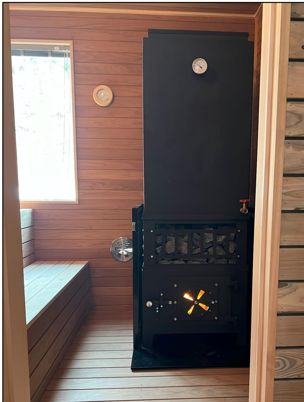
サウナ室に設置 貯湯量 300L サウナストーン 120kg 薪長 50 cm 給湯利用
